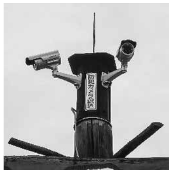
設置した防犯カメラ
