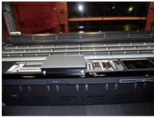
更新後の市民文化ホール 大ホール調光操作卓
