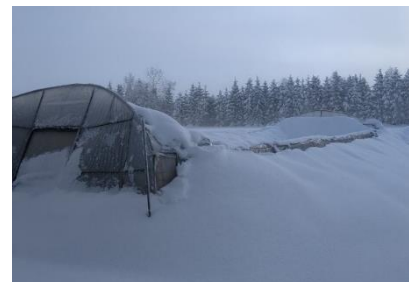
倒壊したビニールハウス
