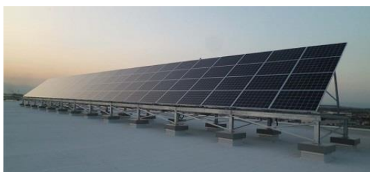
公共施設への太陽光パネルの設置
