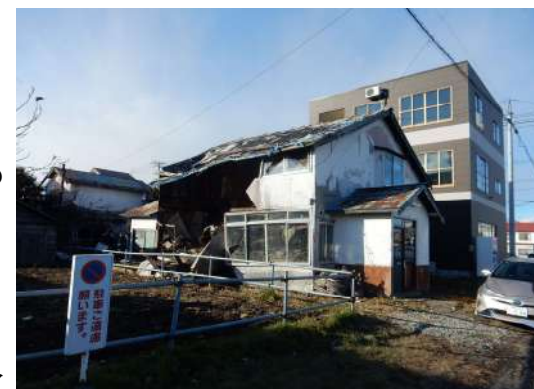
解体につながった特定空き家
