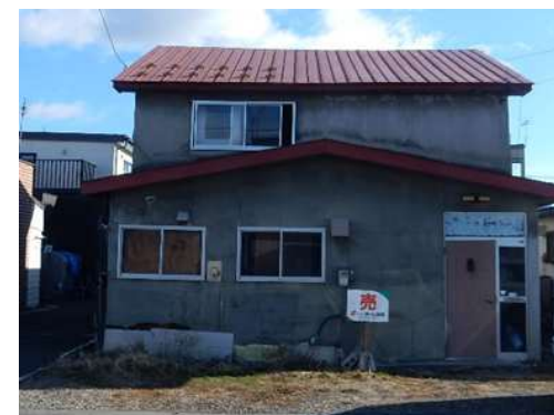
解体につながった特定空家
