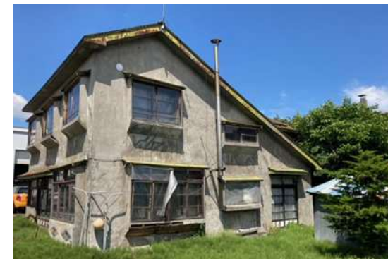
解体につながった特定空き家
