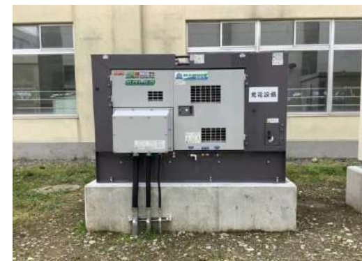
指定避難所に整備した非常用発電機 (光南小学校)
