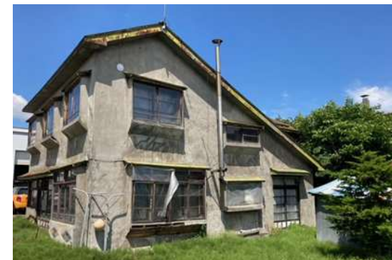
解体につながった特定空き家
