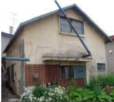
解体につながった特定空家
