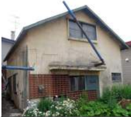
解体につながった特定空家
