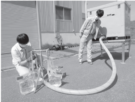
折りたたみ式応急給水コンテナおよび 応急給水栓 (災害対策備蓄資器材)
