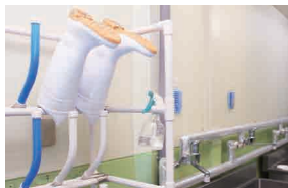
作業現場専用の長靴ラック
