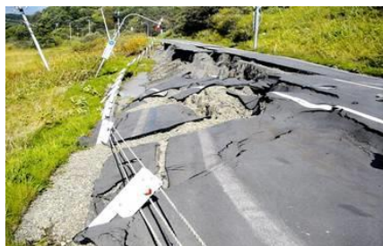
平成 15 年十勝沖地震（豊頃町）
