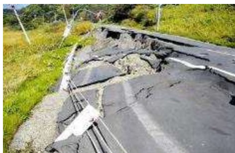
平成 15 年十勝沖地震（豊頃町）
