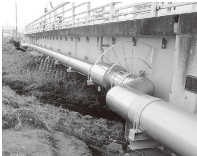
耐震・防寒性能に優れた水道管（橋梁添架管）の整備
