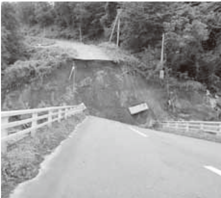
崩落した明星橋（岩内川）
