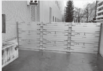
庁舎に設置した止水板
