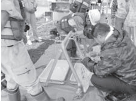
応急給水栓（災害対策備蓄資器材）
