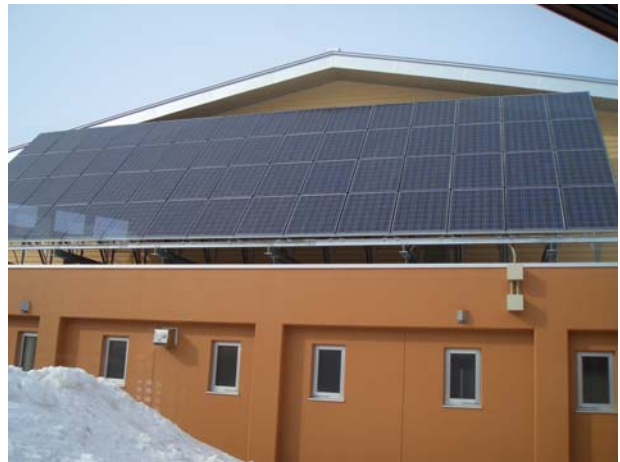
太陽光発電システム（清川小学校）
