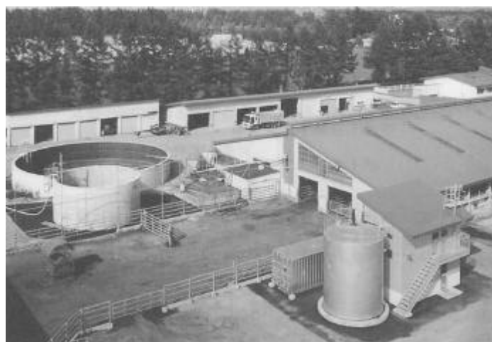
図表 - 帯広畜産大学のバイオガス実証プラント
