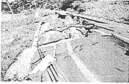
平成 15 年十勝沖地震（豊頃町）
